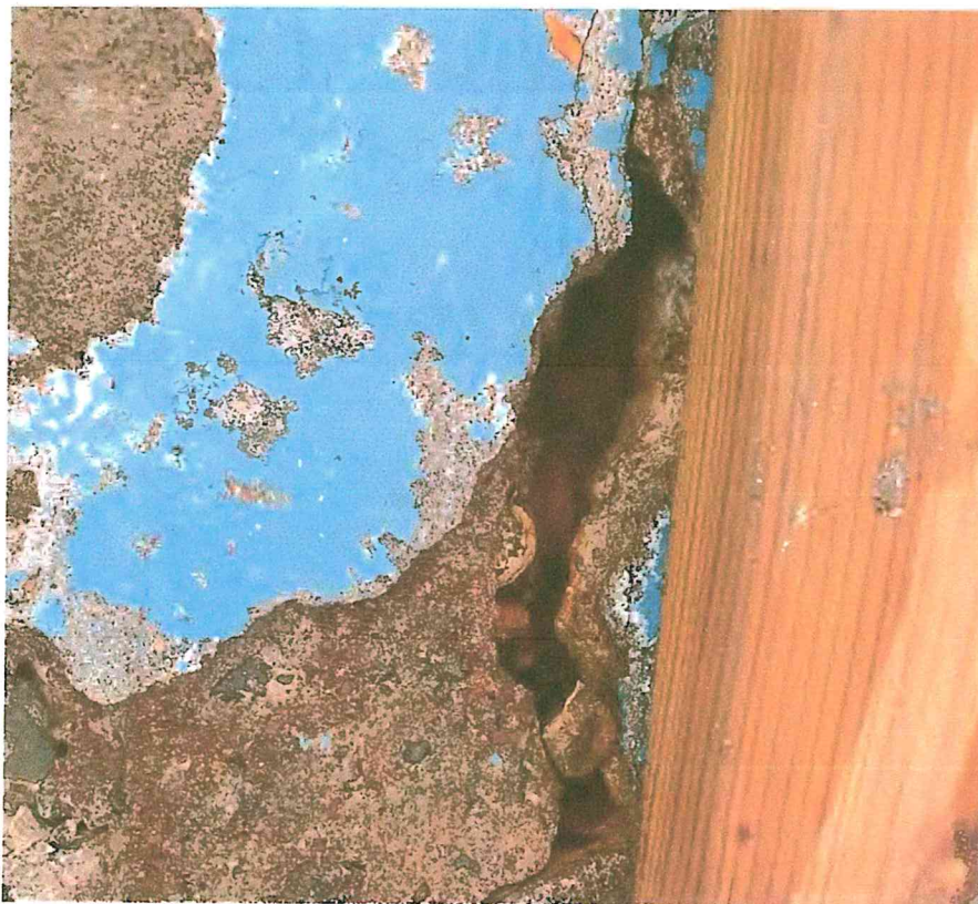
Mynd 9. Skemmdir í steypu og járnum, bæði lykkjum og langjárnnum. Þessar skemmdir eru fyrir neðan plötu og trúlega eru mestu skemmdirnar neðst á vegg, fyrir neðan gluggaröðina.
