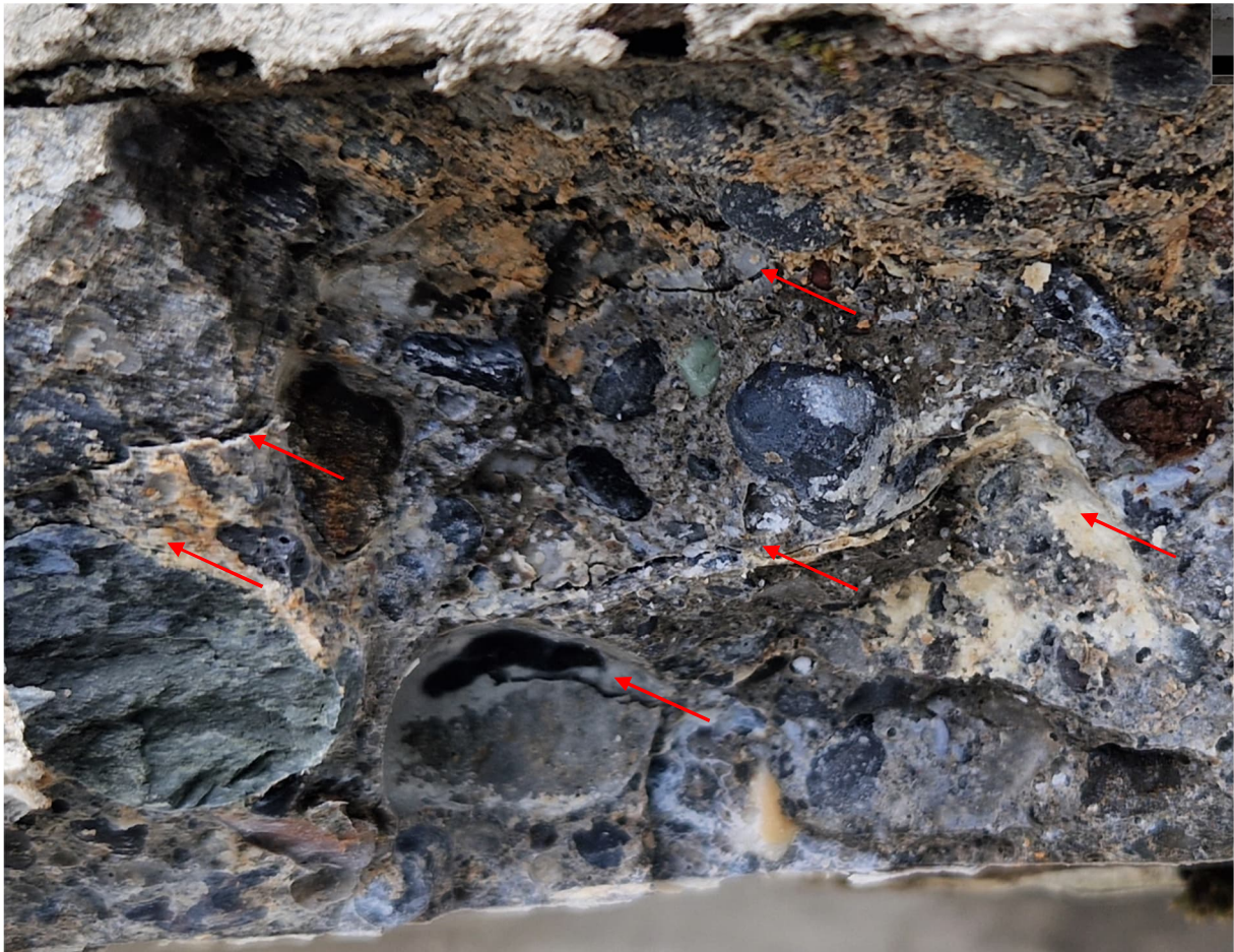
Mynd 2. Nærmynd af alkalískemmdri steinsteypu.
