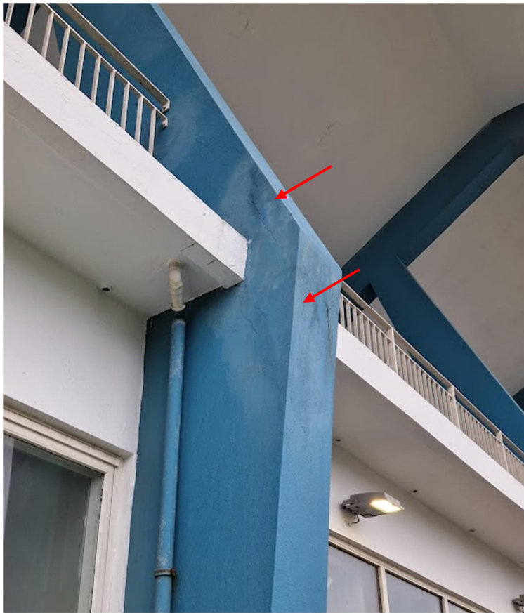
Aukið vatnsálag þ.a.l. auknar skemmdir.
