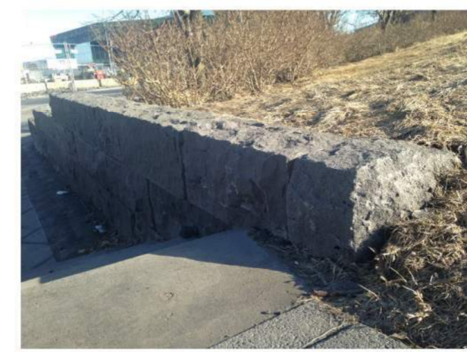
Dæmi um grágrýtishleðslu úr söguðu grágrýti með topp og sýnilegar hliðar tilhoggnar. Mynd frá vegg við Arnahól.
