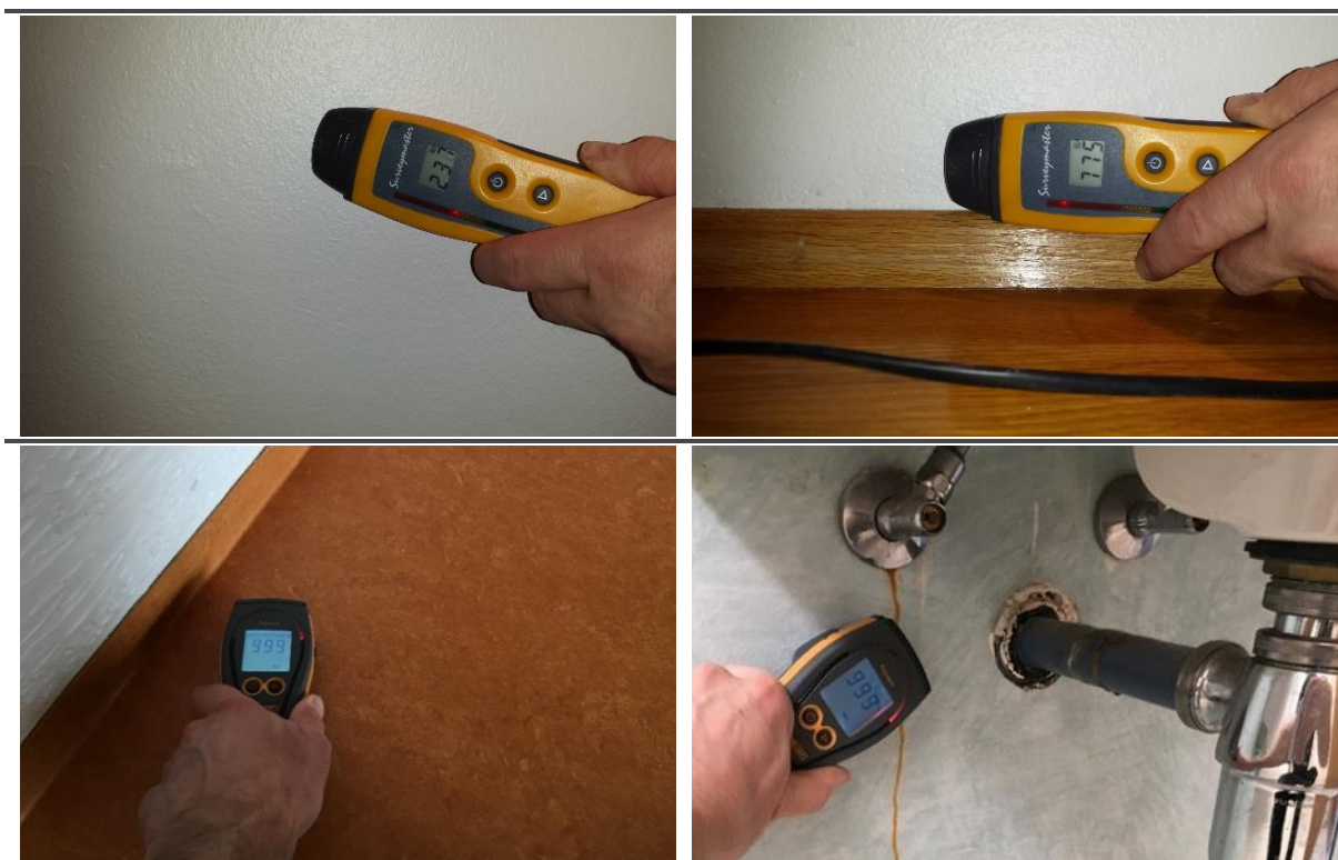
MYND B. Dæmi um viðmiðunarmælingu og frávíkaskráningu; merkt er inn á teikningu hækkaður raki á vegg neðst við gólf. Merkt er inn á teikningu hækkaður raki í gólfi við útvegg. Merkt inn á teikningu hækkaður raki í vegg neðan við vask.
