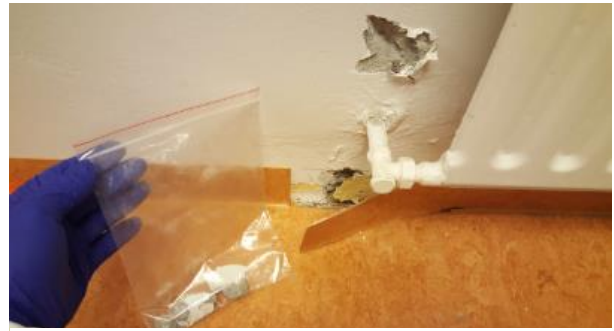
MYND E. Sýnataka úr vegg
