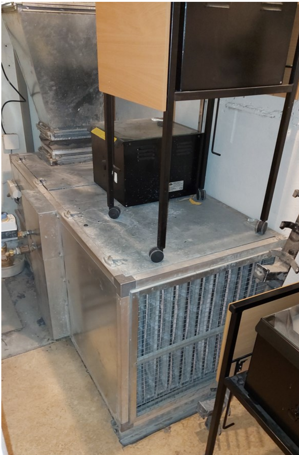
Mynd 7: Loftinntak í kjallara fyrir innblásturs upp á gang fyrir ofan.
