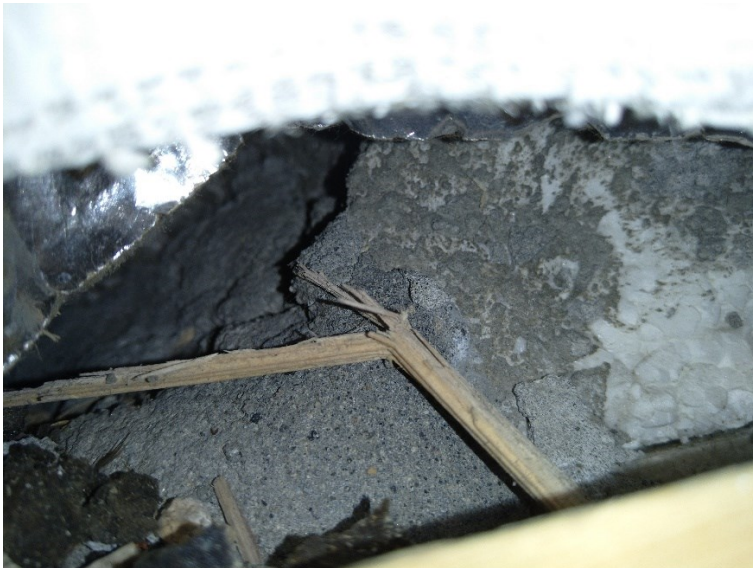
Mynd 3 Leki í horni við inngang á c-gang
