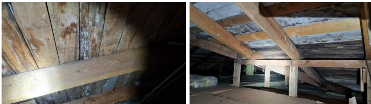
Mynd 22. Rakaskemmdir eru innan á borðaklæðningu í köldu þakrými
