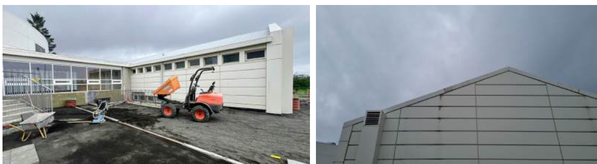
Mynd 17. Verið er að lagfæra dren og annað í C-álmu. Klæðning á C-álmu er óhrein og vatn virðist safnast í samskeyti.
