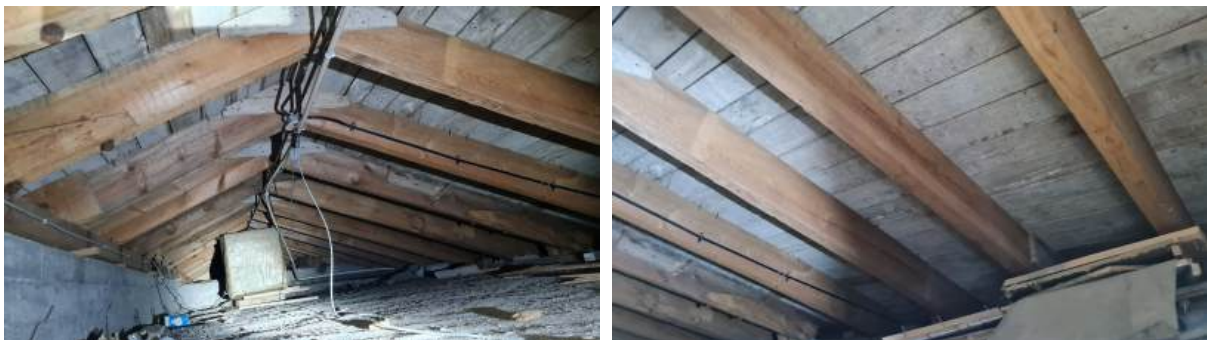
Mynd 5. Séð upp í þakrými A álmu. Borðaklæðning lífur ágætlega út en engin sýnataka hefur þó farið fram
