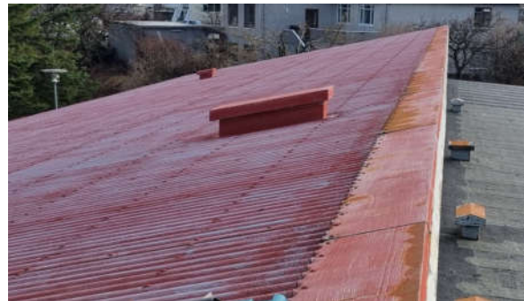
MYND 11 Ástand klæðningar á hápaki. Ryð komið í áfellur og málning orðið mikið veðruð á bárujárnri.
