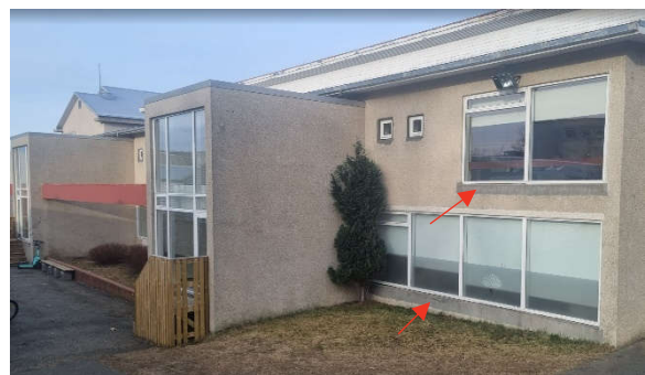
MYND 3 Suðurhlið. Eldri múrviðgerðir.
