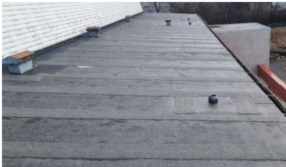
MYND 8 Ástand lápaks. Ráðist hefur verið í viðgerðir fyrir >10árum þar sem soðið hafa verið renningar yfir samskeyti á eldri dúk.
