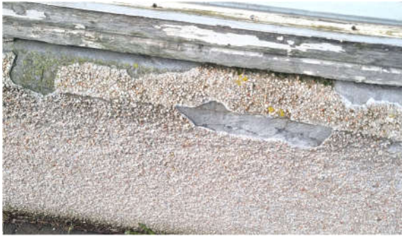
MYND 6 Ástand glugga og múrs á austurhlið. Hækkaður hlutfallsraki mældist við glugga að innan.
