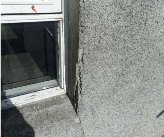
Mynd 10. Sprungur í útvegg austurinngang
