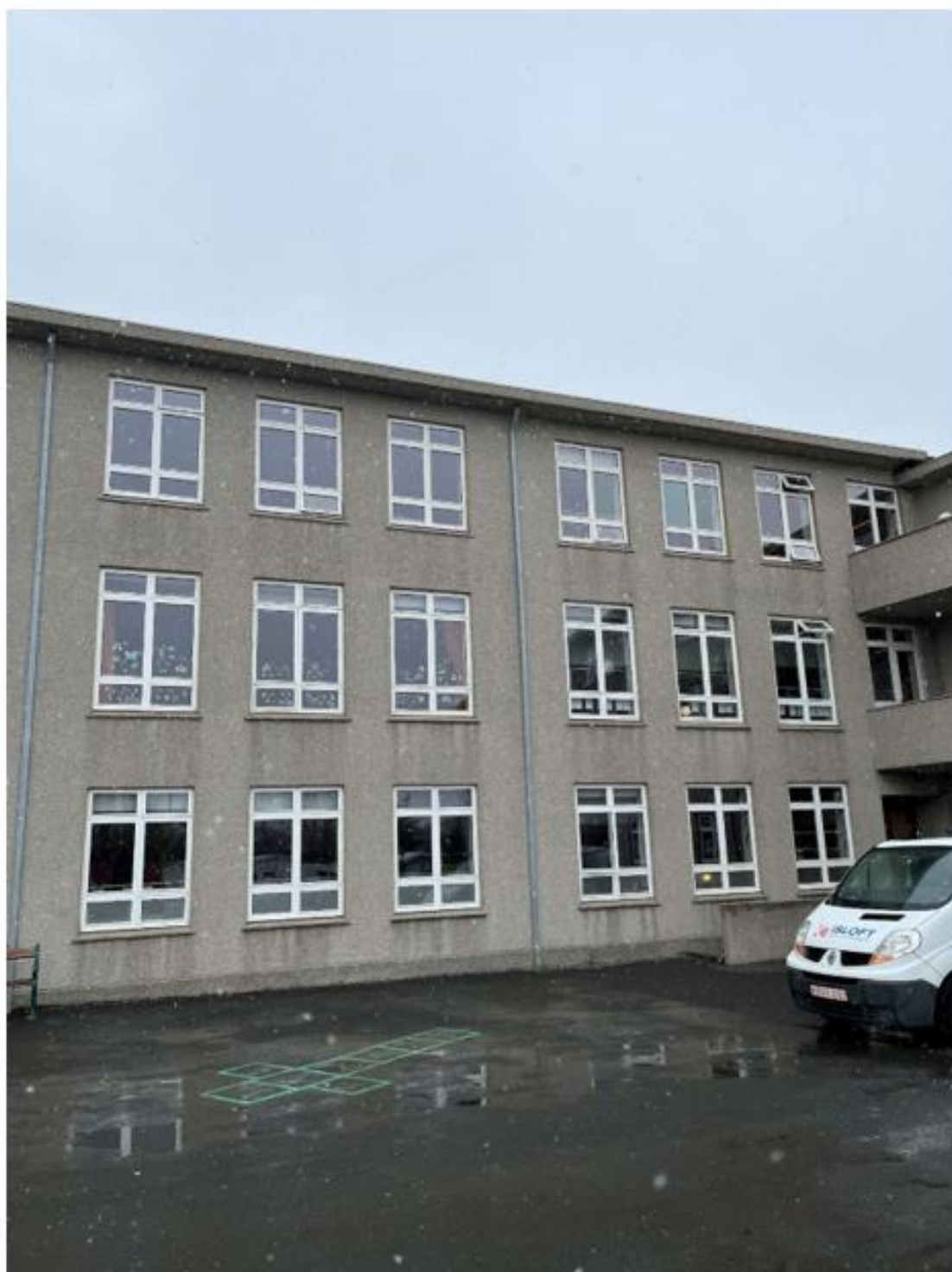
Mynd 59A. Eldri álmu. Fillcoat efni borið í kringum glugga til að koma í veg fyrir leka.
