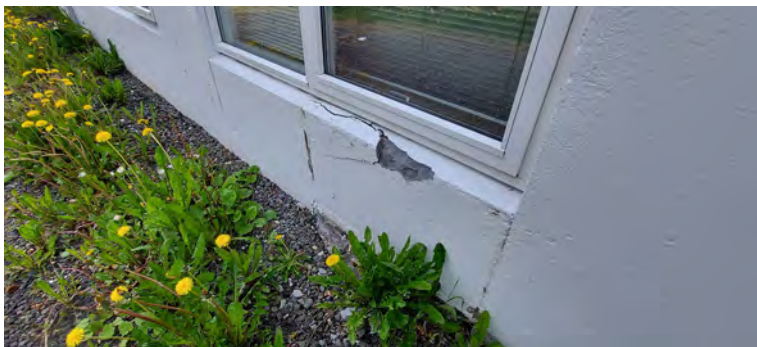
Mynd 5: Bakhlíð hússins. Útveggir illa farnir.
