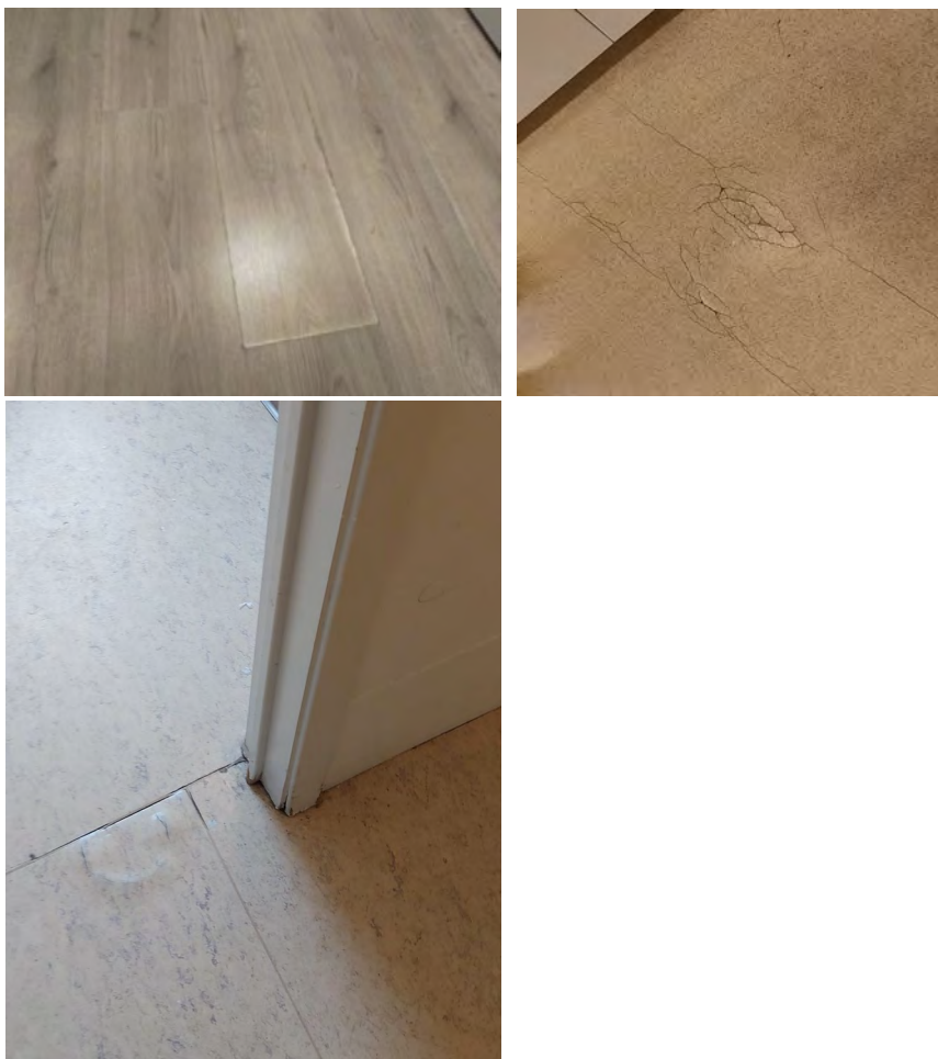
Mynd 20: Gólfefni er víða laust frá og ónýtt vegna rakaskemmda.
