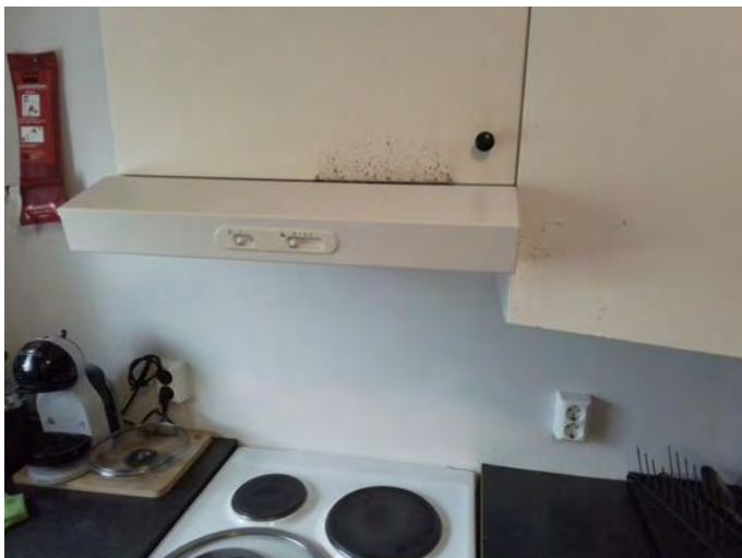
Mynd 25: Innréttingar í eldhúsi eru víða illa farnar og undantekningalaust efri skápar fyrir ofan víftur.
