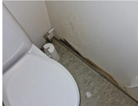
Mynd 4 Veggur á salerni fyrstu hæðar illa farin
