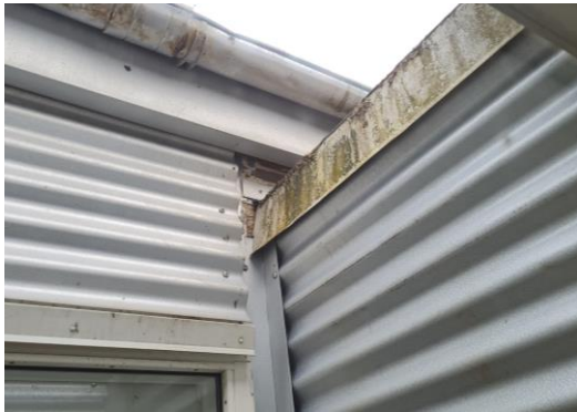
Mynd 7 Ófullnægjandi frágangur á tengibyggingu við færanleg kennsluhús
