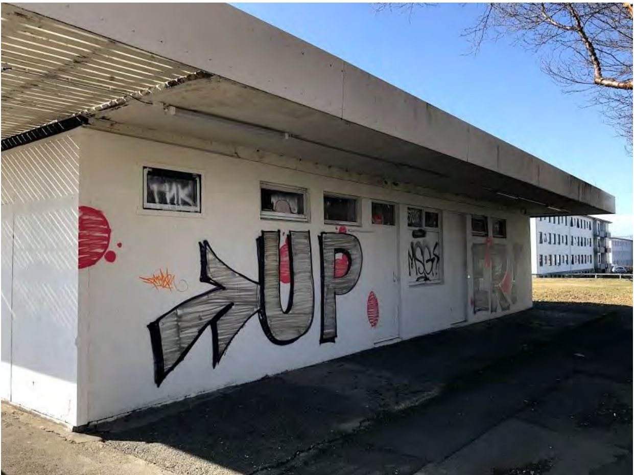
Mynd 12. Austurhlið Arnarbakka 2. Hér var áætlað að hafa almenningsasalerni, en sennilega voru þau aldrei starfrækt. 40
